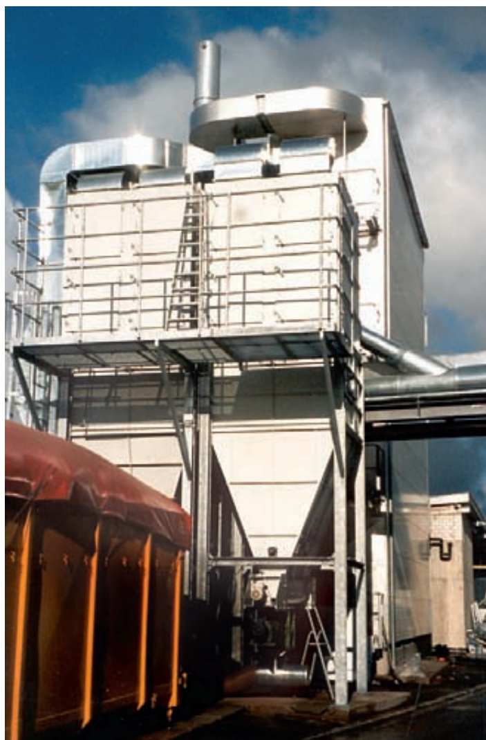
Система аспирации и очистки воздуха металлургического производства
