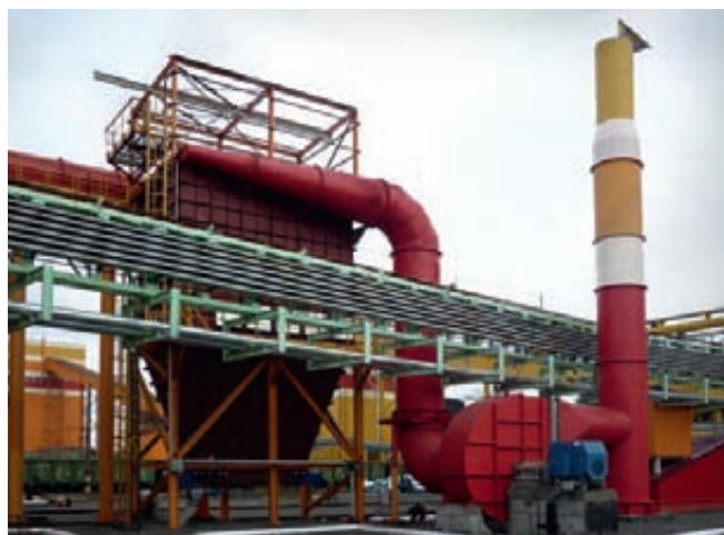
Системы пылегазоочистки и аспирации
