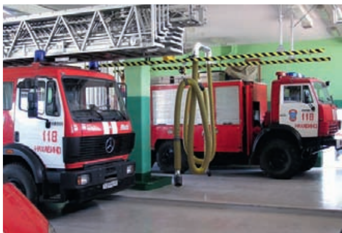
Пожарная часть на четыре выезда, оснащенная системами удаления выхлопных газов модели SBT
