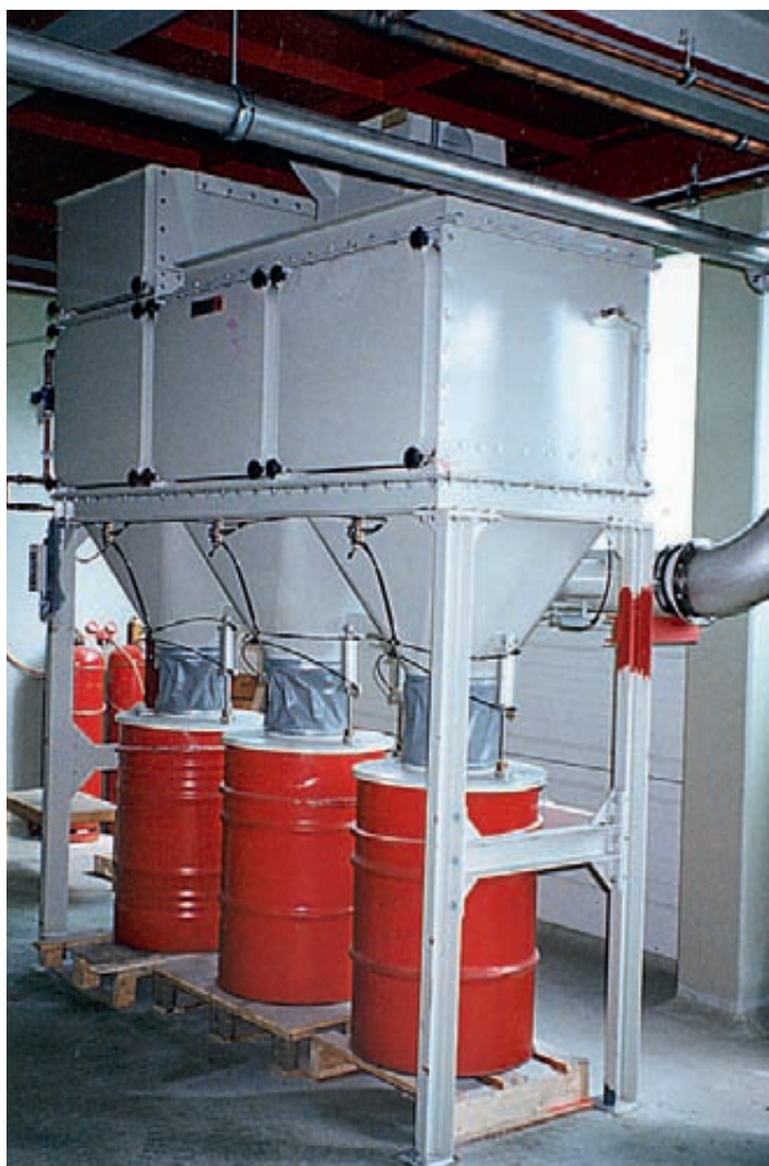
Взрывозащищенная система вентиляции
