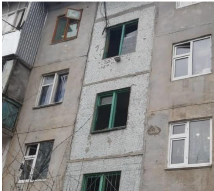
Рисунок 6. Состояние окон квартир и подъезда жилого дома на расстоянии 30 м
