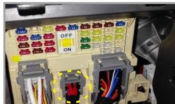
14. Подключите провод питания блока управления к проводу +12V штатного блока предохранителей салона а/м
