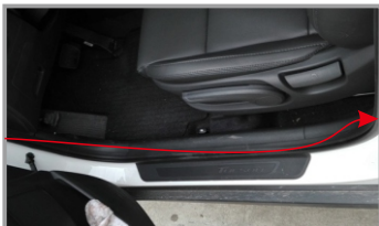
17. Демонтируйте декоративные пороги водительской стороны. Уложите питающий кабель вдоль штатной проводки а/м
