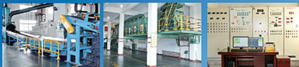
先进的全自动炼胶生产线（上辅机）（下辅机）（中控室）
