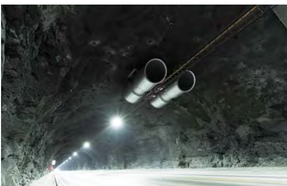
Туннели «Vufjord» и «Mastrafjord», Норвегия Струйные вентиляторы для туннелей
