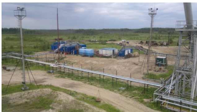
Рис. 1. Действующая газопоршневая установка.
