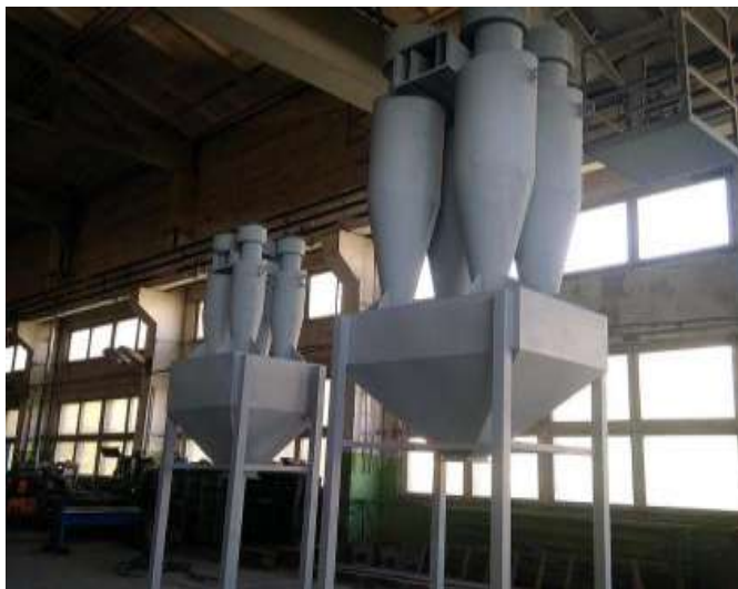
Рисунок 5 - Батарейная установка циклонов 4 БЦШ
