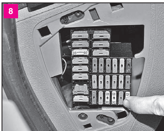
Перегоревший предохранитель можно определить по обрыву токопроводящей полоски. Новый предохранитель вставляем в гнездо блока до упора
