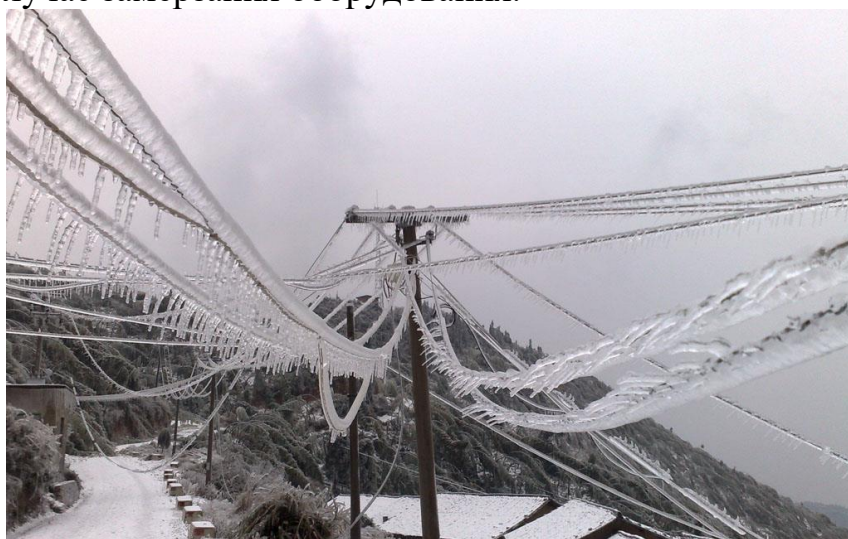
Рисунок 1 – Процесс обледенения линий электропередач
