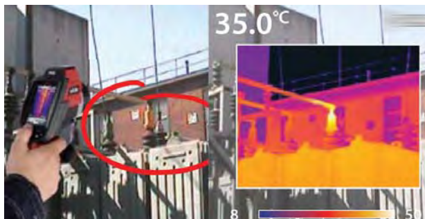
Температурный контроль трансформатора
