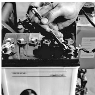
Подсоединение силового кабеля к минусовой клемме АКБ
