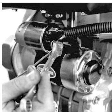
Подсоединение силового кабеля к клемме «плюс» втягивающего реле электростартера
