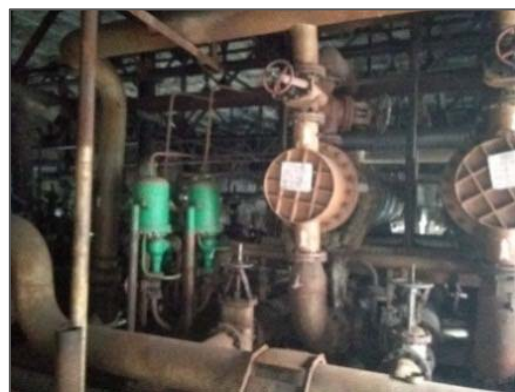
Машинный зал котельной
