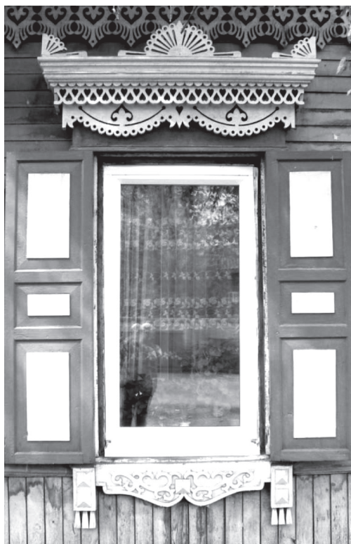
Рис. 52. Исчезновение знака поля в верхней части наличника и замена его на модные рюшечки; лишенное смысла дублирование знака солнца в нижней части окна (ул. Горная, 17 а. Фото М. Мееровича)
