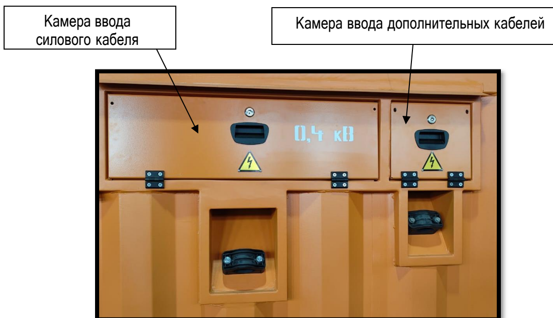
Рисунок 2 - Внешний вид шкафа ввода 0,4 кВ
