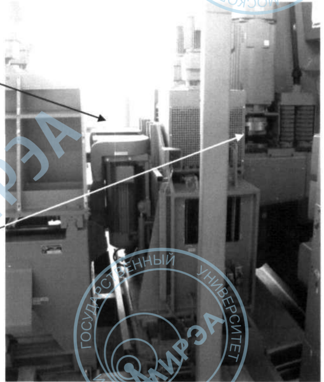
2 двигателя по 18 кВт
