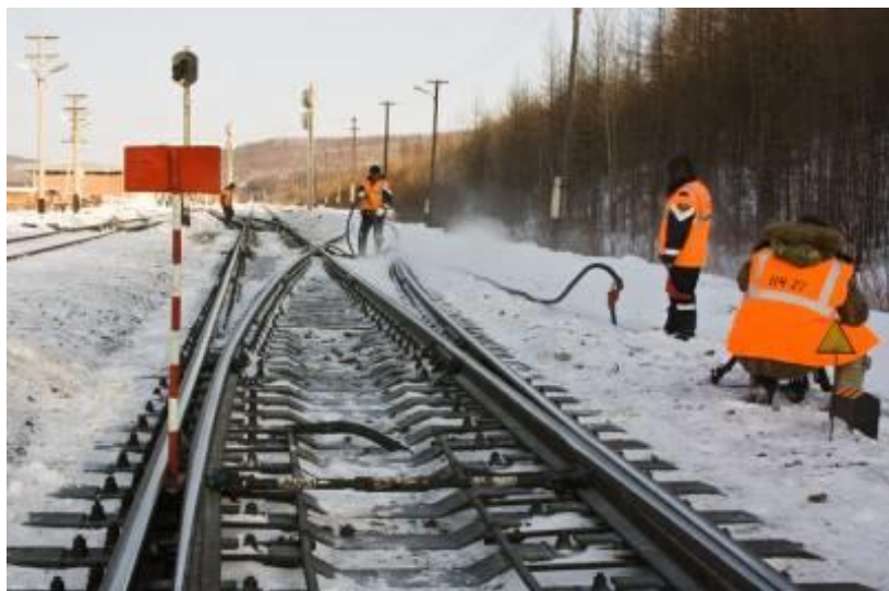
Рис. 14. Стационарные устройства пневмоочистки стрелок от снега и устройства ручной шланговой пневмообдувки.
