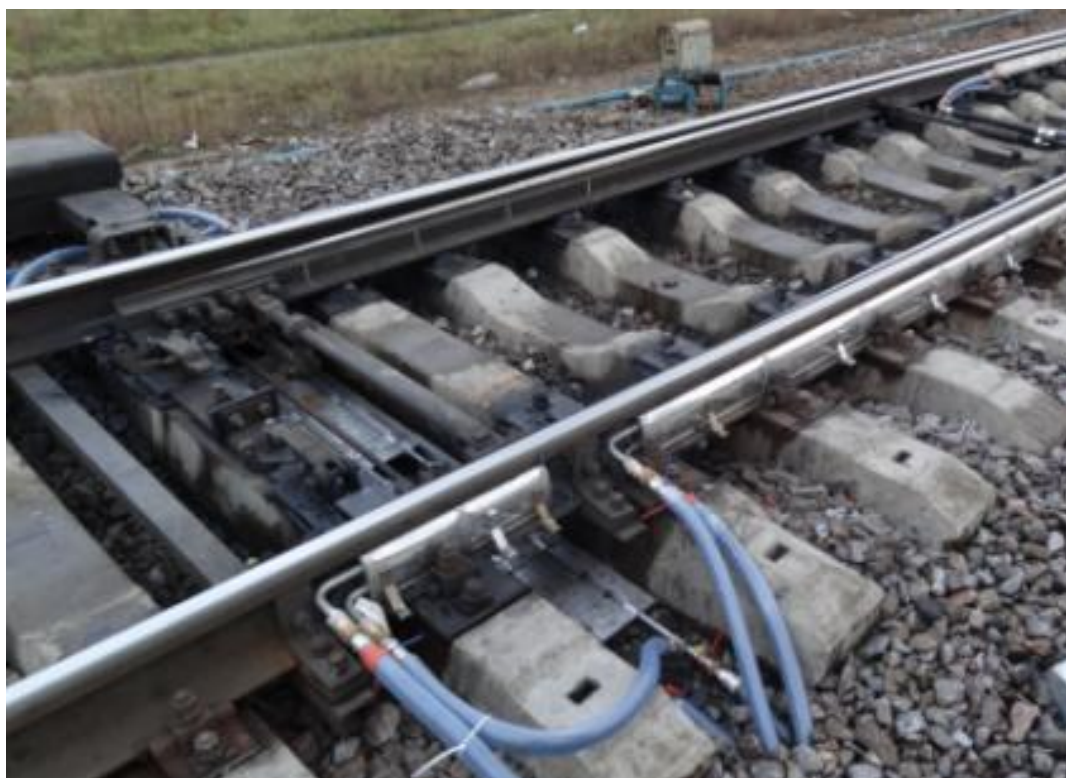
Рис. Система геотермического обогрева стрелочного перевода.
