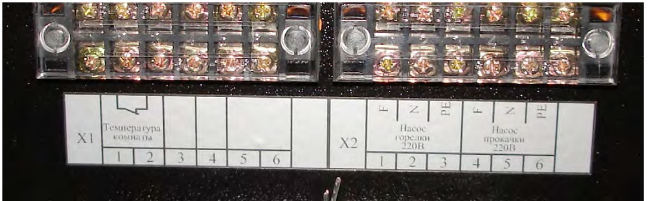
Фото 11в. Подключение дополнительных устройств
