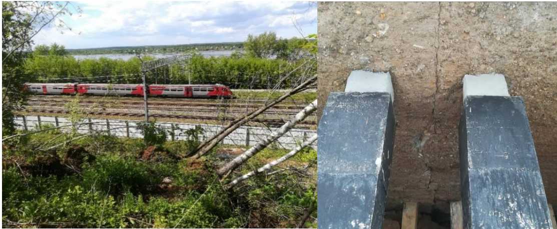
Рис. 8. Слева - язык оползня, справа – трещина дороги в 2020 году (фото автора).
