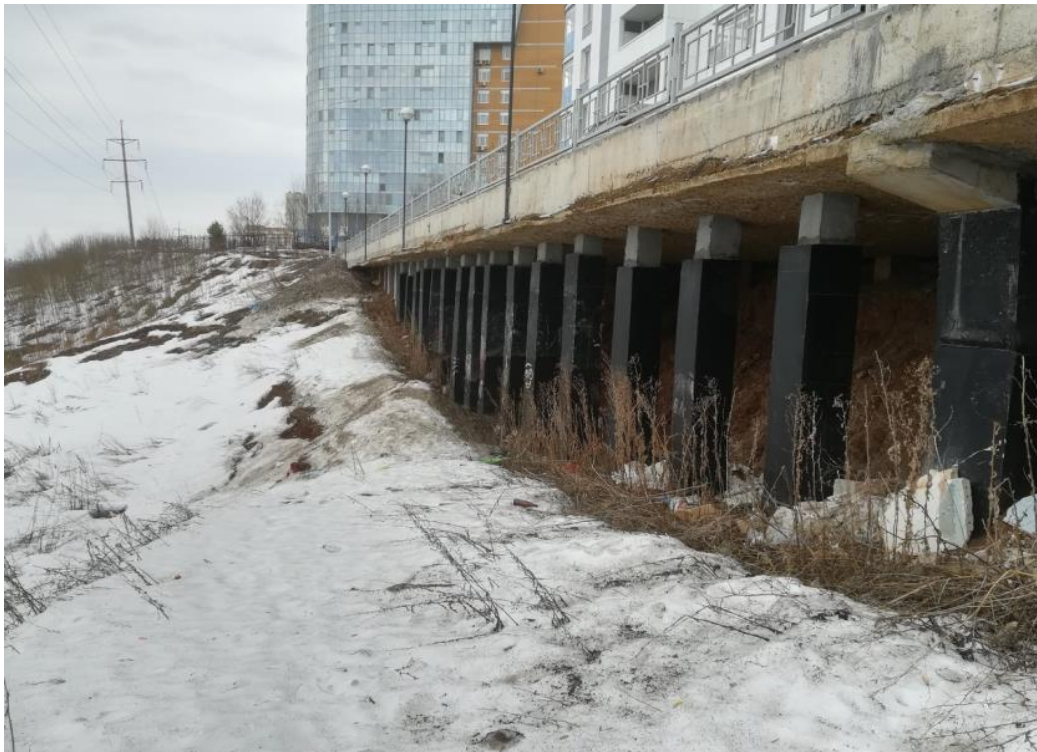
Рис. 5. Общий вид оползня в апреле 2020 г. (фото автора)
