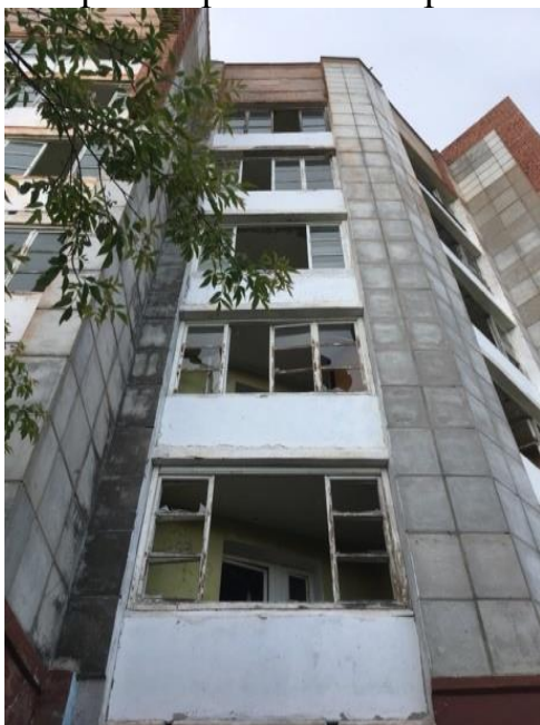
Рис. 7. Аварийный дом на ул.Гашкова 28Б.
