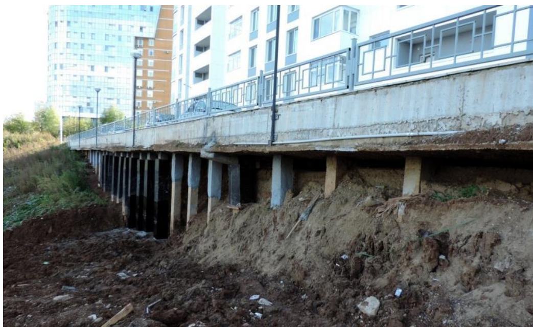
Рис. 4. Общий вид оползня в октябре 2017 г. [15]
