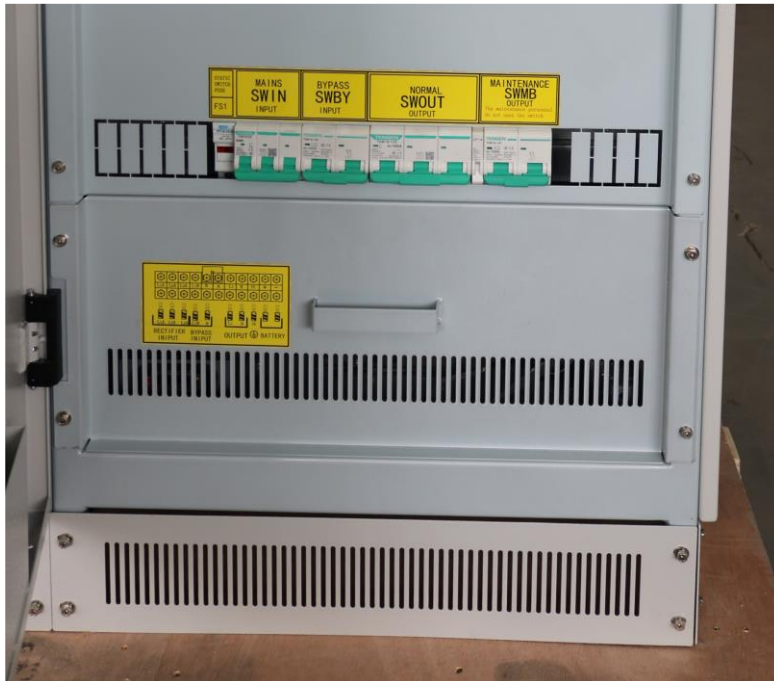
Рисунок 11. Крышка распределительной панели ИБП 20кВА
