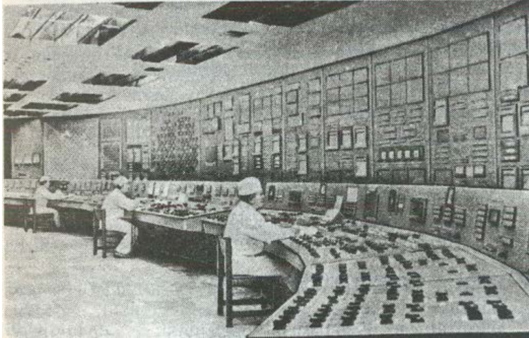
Рисунок. 1.1. Щит управління енергоблоком електричної станції
