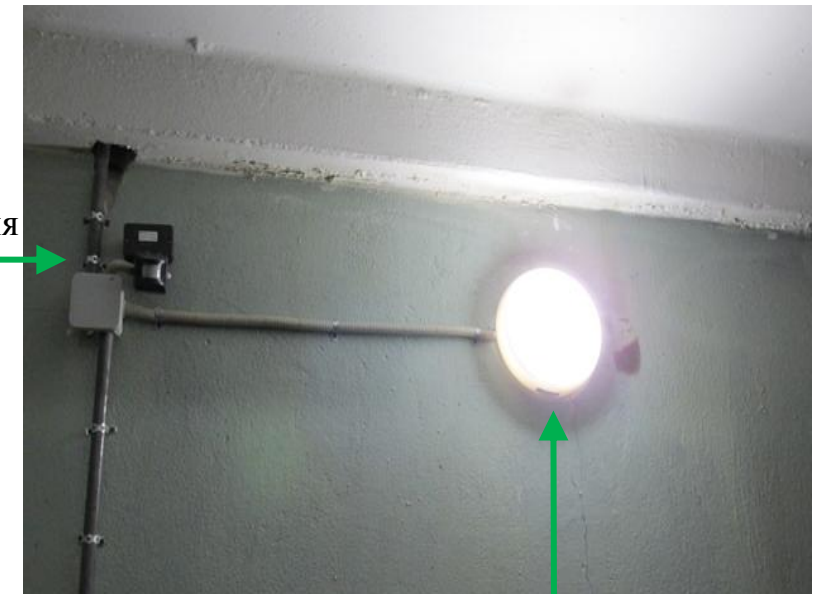
Пример практического применения энергосберегающего освещения в местах общего пользования
