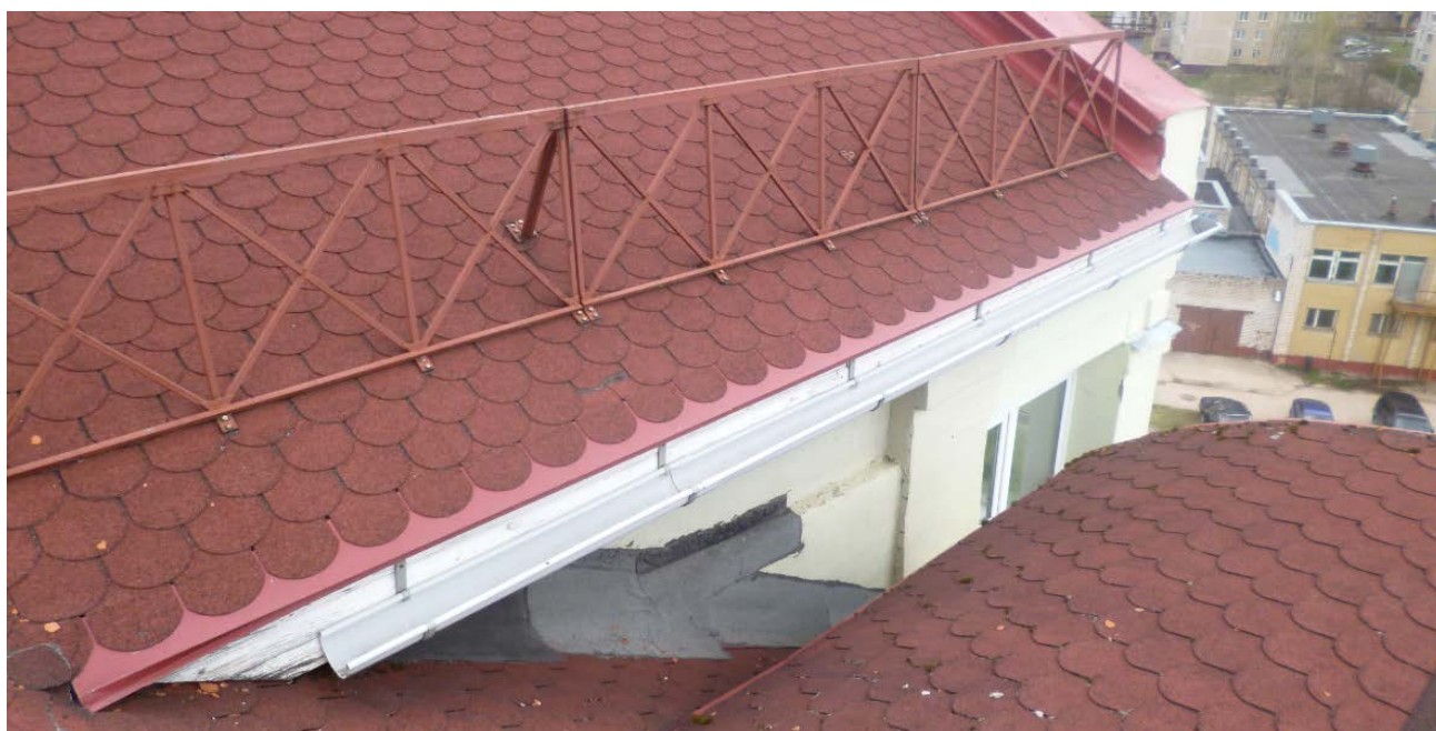
Фото Ф-14. Местный водосток на кровле, ориентированный на кровельный ковер без мер по его усилению и вызывающий повышенный уровень влажности в примыкающих стенах.
