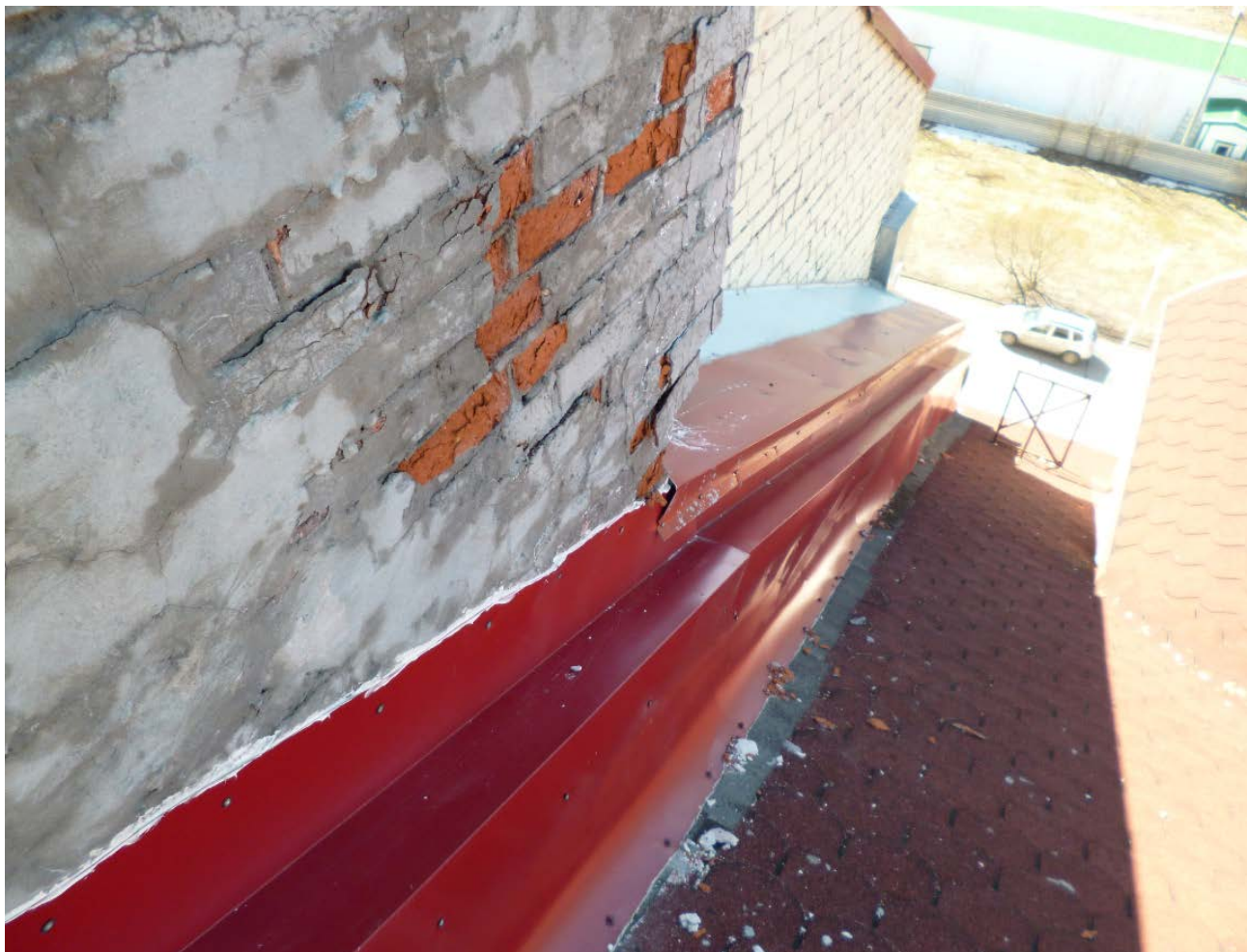
Фотофрагмент 11. Морозная деструкция кирпичной кладки вентиляционной шахты
