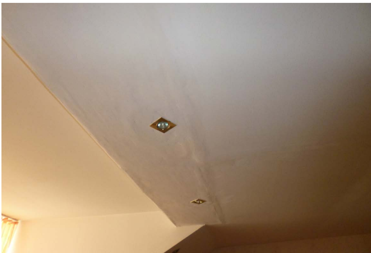
Фотофрагмент 22. Места ремонта отделки потолка в аналогичном месте в помещении другой квартиры мансардного этажа (кв.18)
