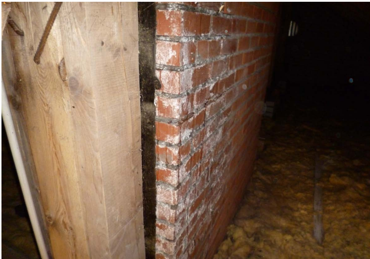
Фотофрагмент 15. Следы замачивания вентиляционной шахты в чердачном пространстве
