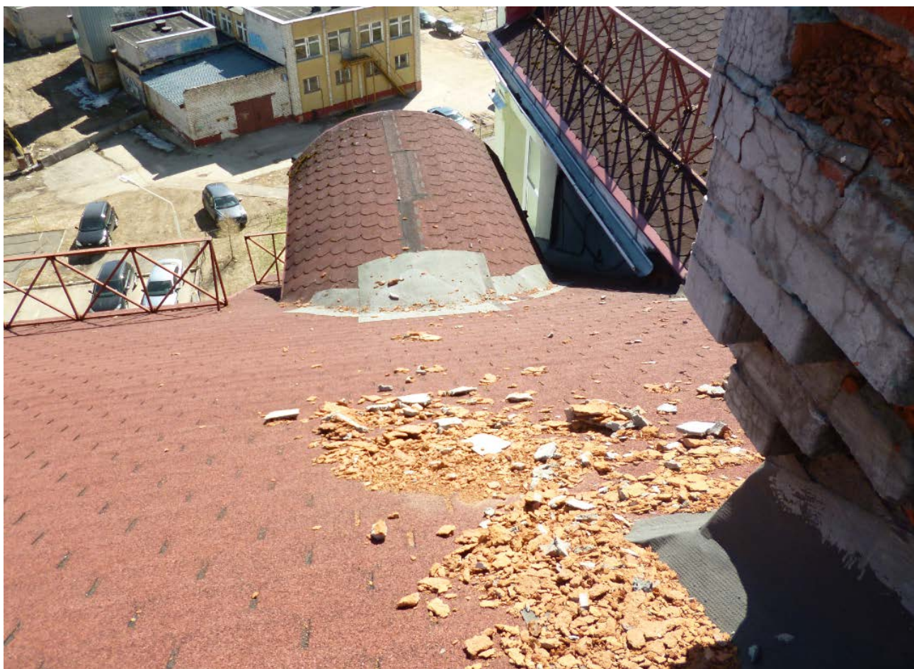
Фотофрагмент 6. Фрагменты обрушения кладки. Имеется высокая вероятность падения обломков с крыши
