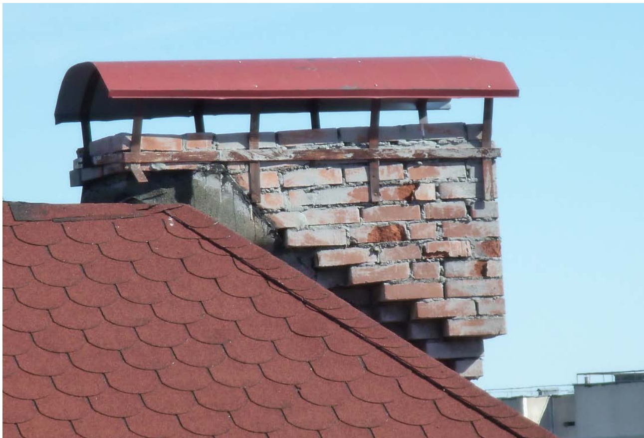
Фотофрагмент 5. Морозная деструкция кирпичной кладки вентиляционной шахты
