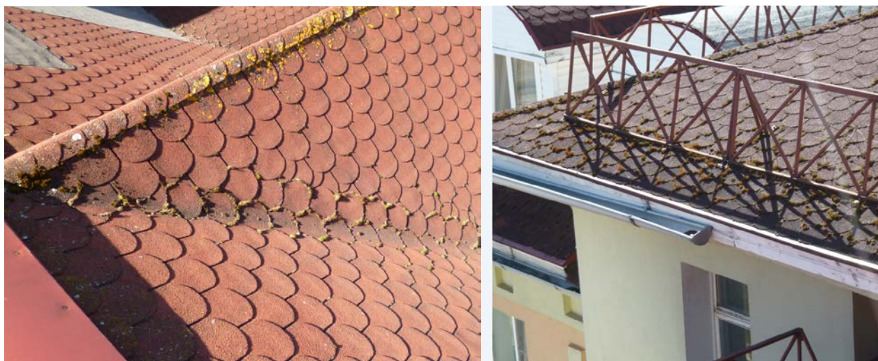
Фото Ф-13. Поросли мха на отдельных участках кровли
