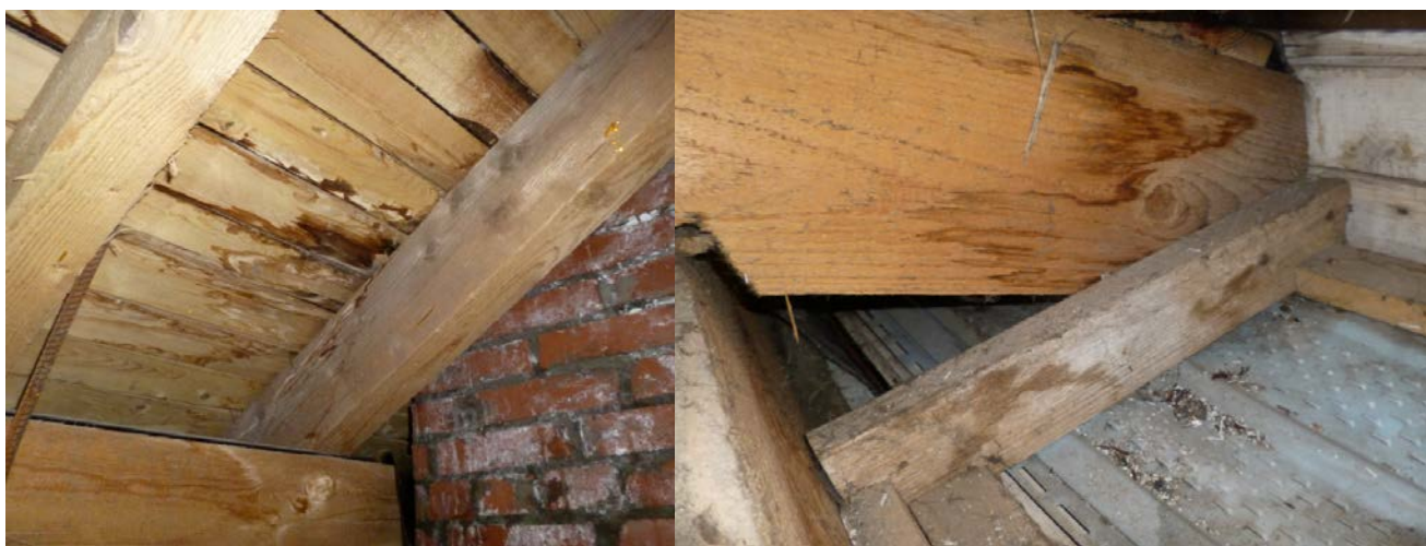
Фото Ф-8. Следы незначительного воздействия влаги (следствие протечек кровли) на стропильные ноги.
