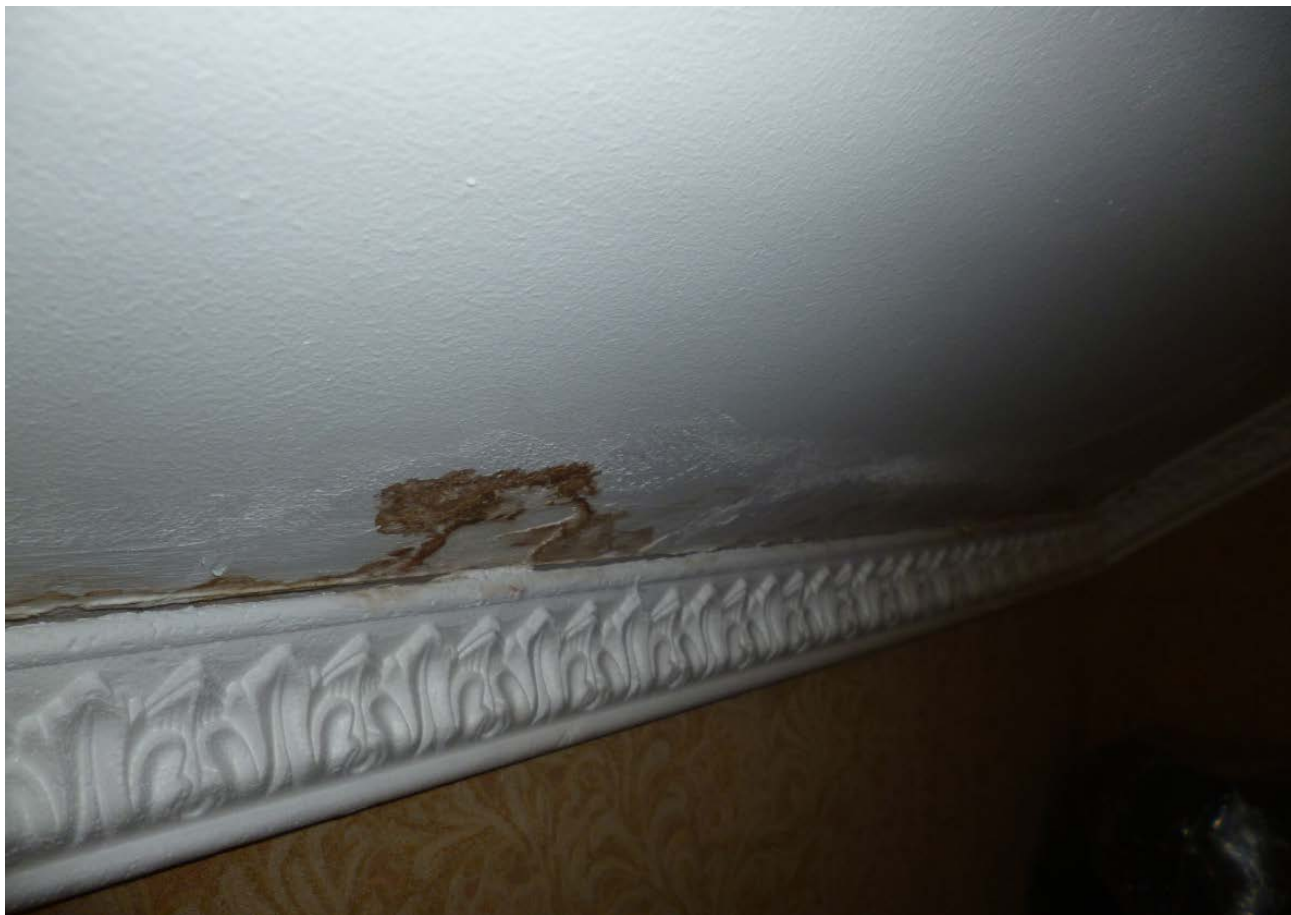
Фотофрагмент 21. Следы протечек под сводчатым окном в квартире мансардного этажа
