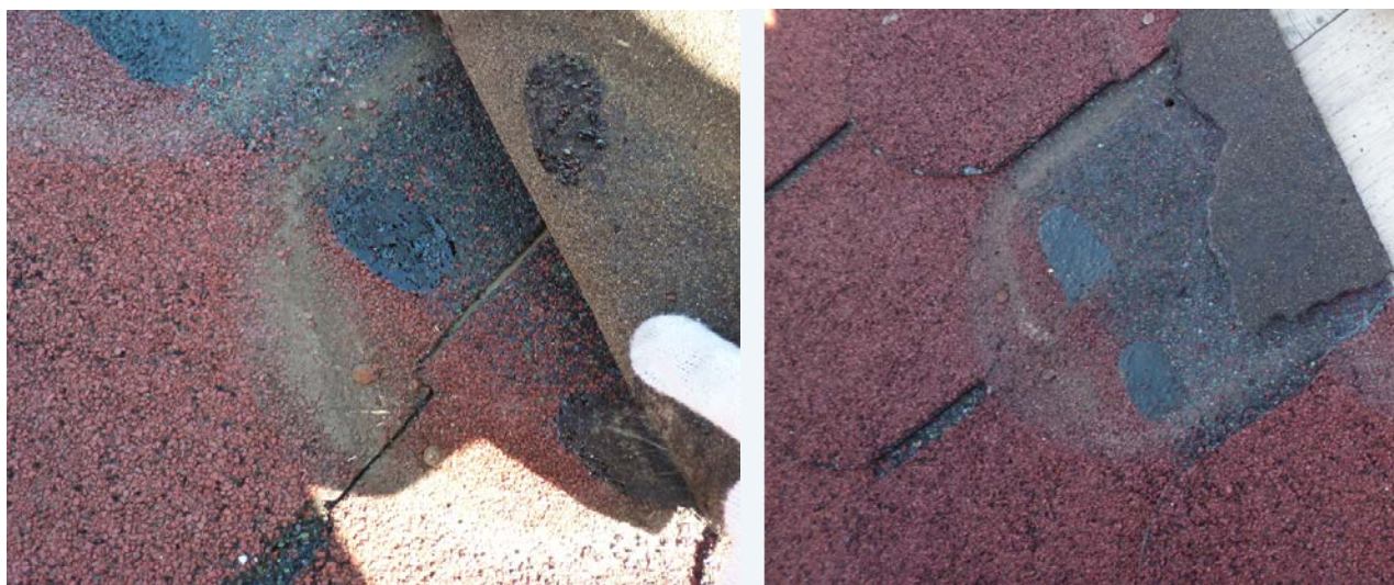
Фото Ф-12. Коррозия крепежных элементов как на открытых, так и на закрытых участках; вырыв крепежных элементов.
