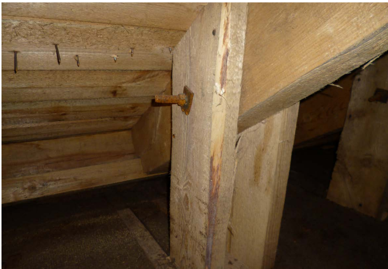
Фотофрагмент 18. Незначительная коррозия нагеля в узле сопряжения
