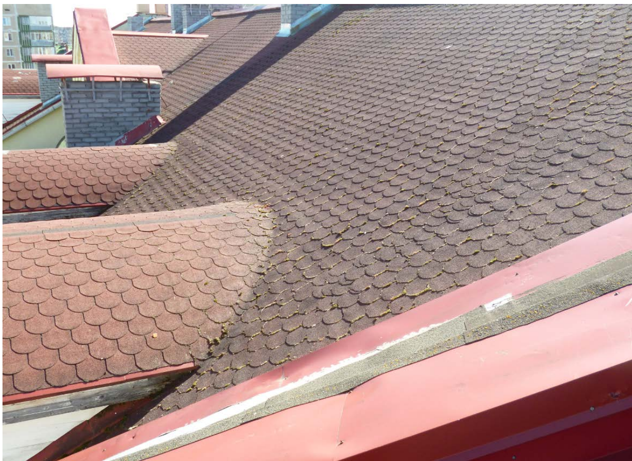
Фотофрагмент 14. Незначительные поросли кровельного ковра мхом
