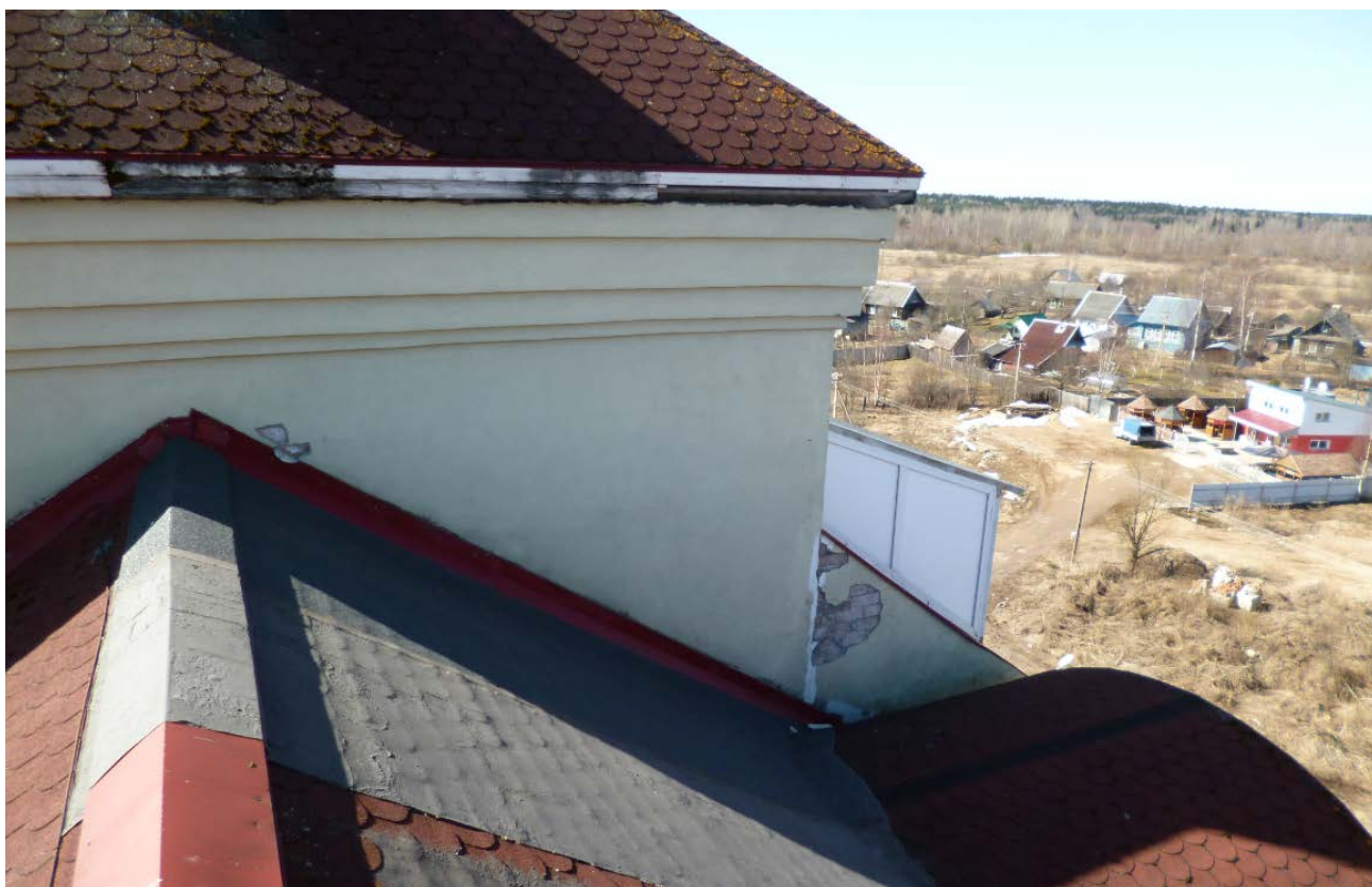
Фотофрагмент 2. Повреждение штукатурного слоя, скопление мха, усиление кровельного ковра рулонными материалами, биоповреждения карнизной обшивки
