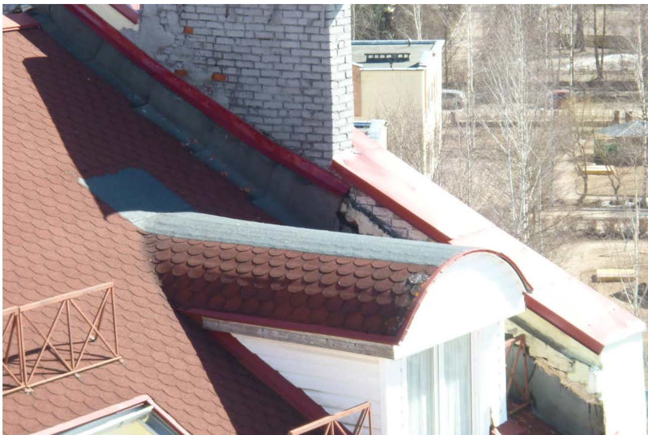
Фотофрагмент 4. Отсутствие примыкания кровли к парапету по оси «1» угловой секции
