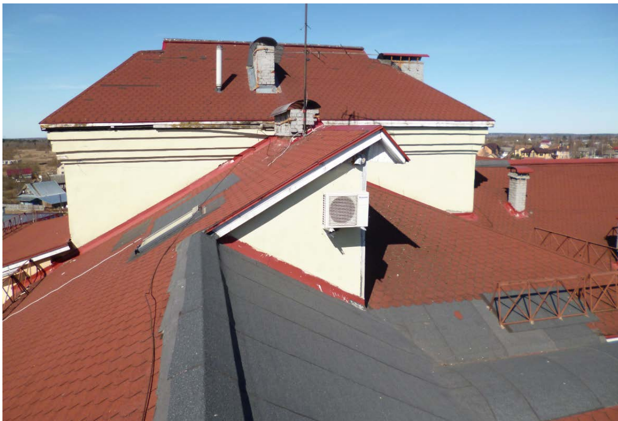
Фотофрагмент 12. Обширные участки ремонта кровельного ковра
