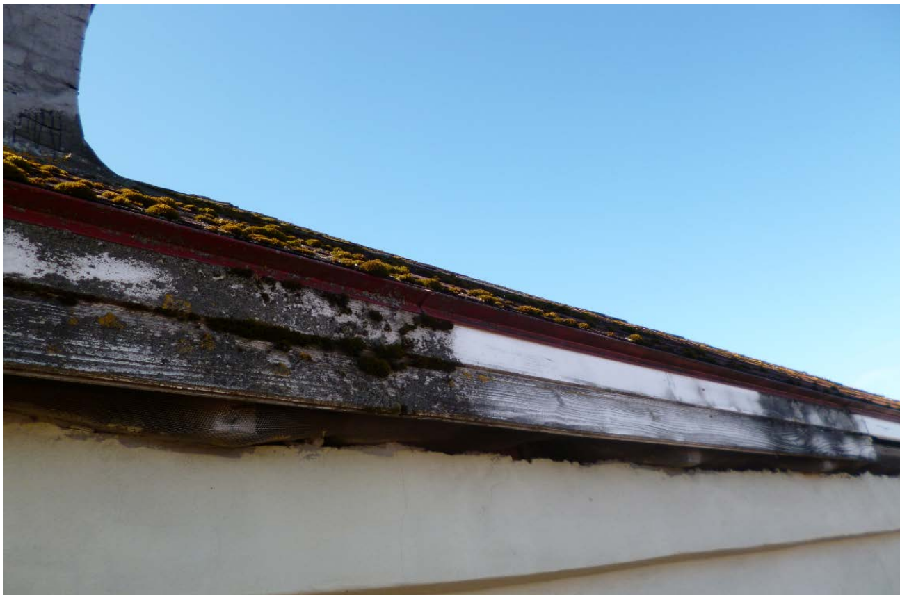
Фотофрагмент 3. Значительное биоповреждение деревянной обшивки вследствие отсутствия организованного водостока
