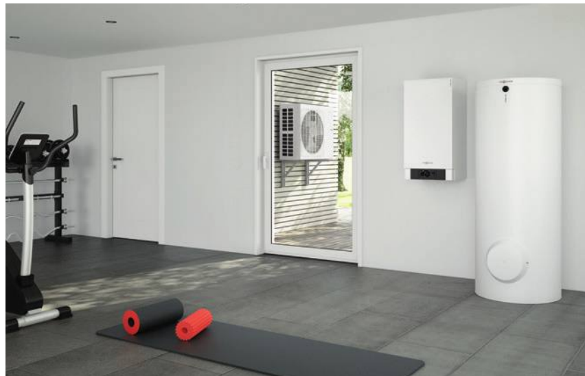
Сплит тепловой насос воздух-вода Vitocal 100-S (внутренний блок), накопительный водонагреватель Vitoscell (справа) и внешний блок
