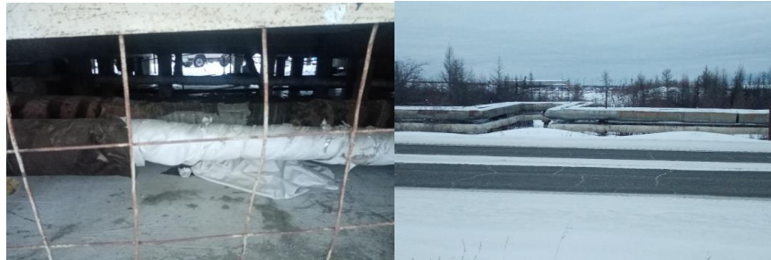
Рис. 19, 20 Водопроводные и канализационные трубы
