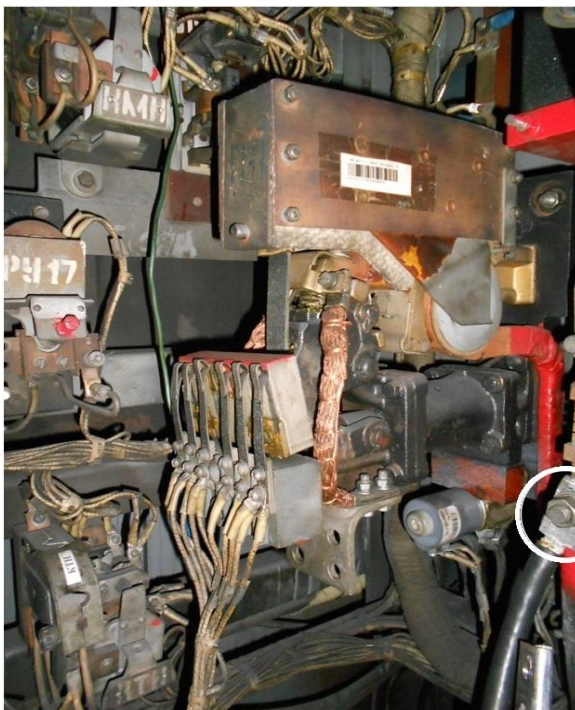
Рисунок 7 – подключение минусового силового кабеля ПОМ к шунту амперметра
