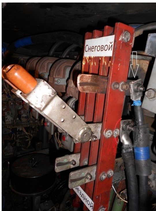
Рисунок 6 – подключение плюсового силового кабеля ПОМ к переключателю РШК №56
