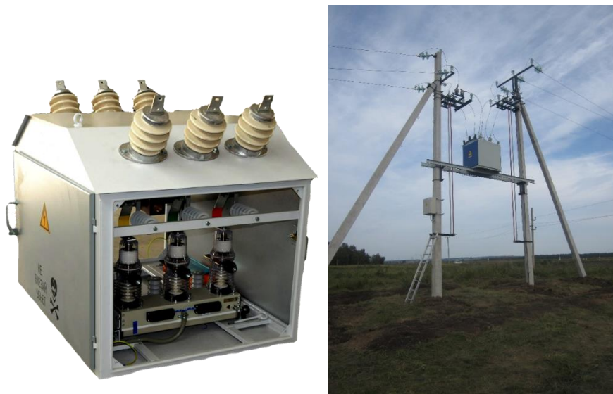
Рисунок 2 – Внешний вид вакуумного реклоузера и размещение его на линии 10 кВ
