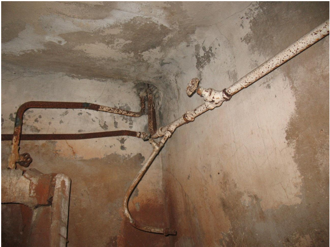
Коррозия труб теплоснабжения, следы ремонта труб отопления Фото 5 – Фрагмент труб отопления в подвале;
