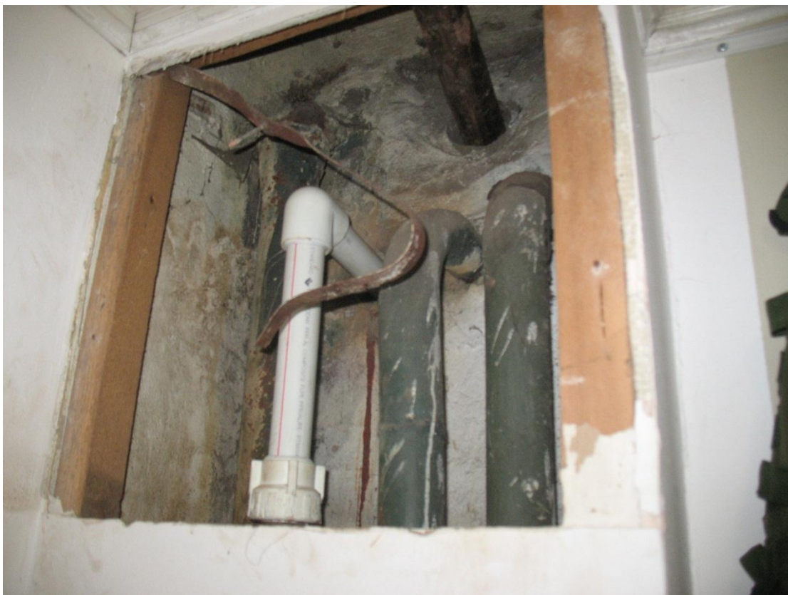
Коррозия труб и следы ремонта Фото 10 – Фрагмент труб холодного водоснабжения и отопления в подвале;
