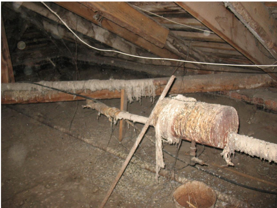
Коррозия труб системы отопления Фото 7 – Фрагмент труб отопления на чердаке;
