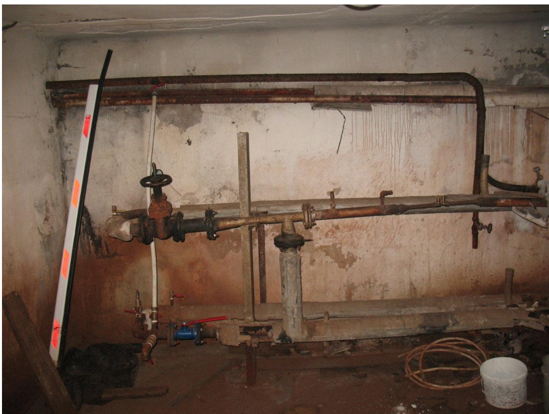
Коррозия труб водопровода и отопления Фото 4 – Вид 2 теплового узла в подвале;
