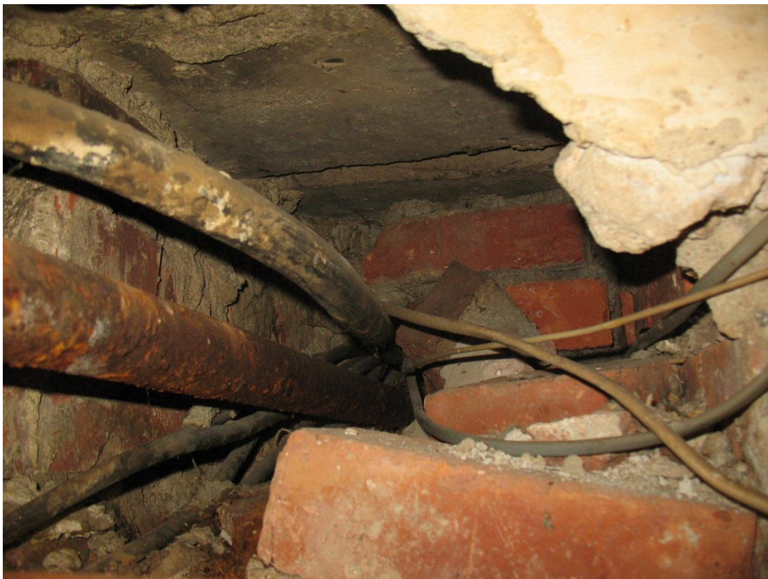
Коррозия труб холодного водоснабжения Фото 9 – Фрагмент труб холодного водоснабжения в подвале;
