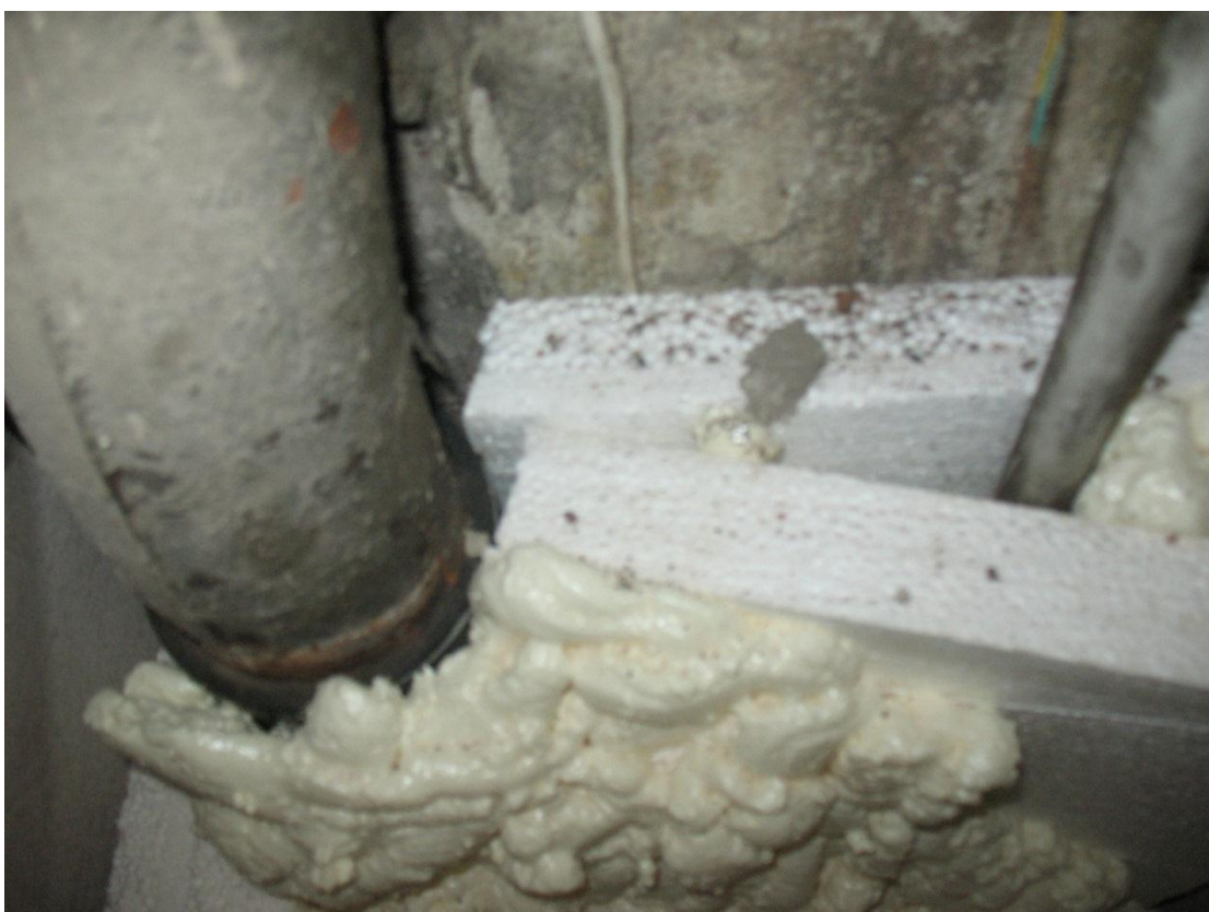
Коррозия труб и следы ремонта
