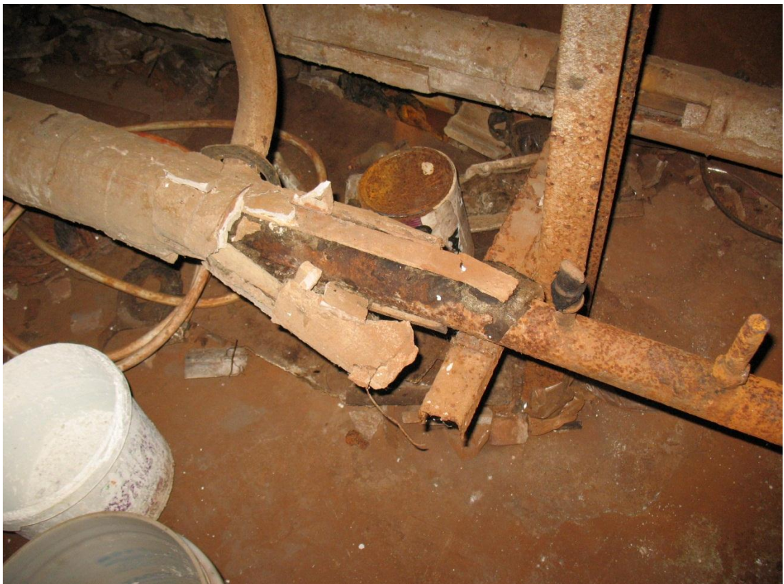
Коррозия труб отопления Фото 6 – Фрагмент теплового узла в подвале;
