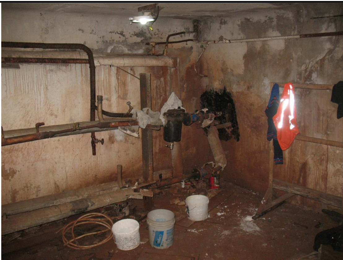
Коррозия труб водопровода и теплоснабжения Фото 3 – Вид 1 теплового узла в подвале;
