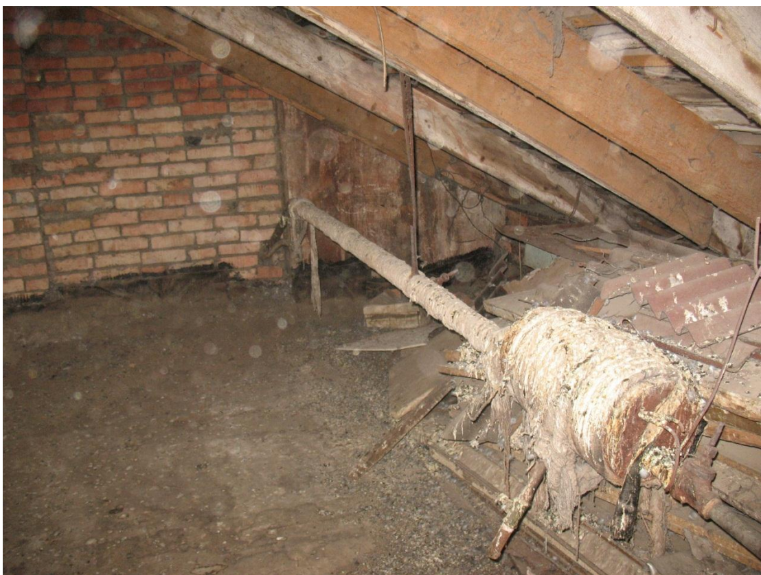
Коррозия труб системы отопления Фото 8 – Фрагмент труб отопления на чердаке;
