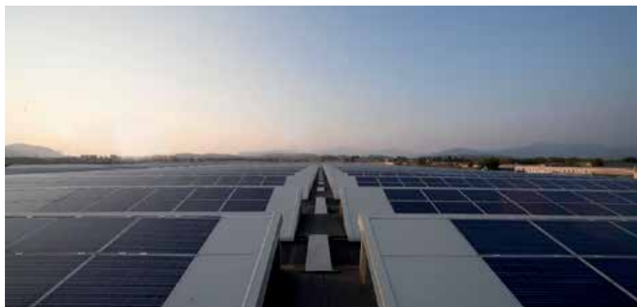
Крыша здания компании, выполненная из фотоэлементов
