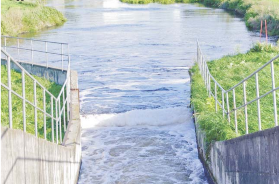
Выпуск очищенной воды на Люберецких очистных сооружениях
